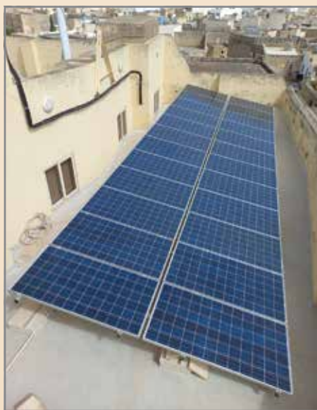
Is-sistema tal-panelli fotovoltajiki ta' fuq il-bejt tal-kažin
