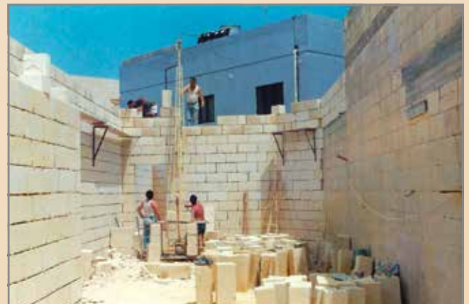
Il-bini ta' wieħed mill-imħażen tal-armar
