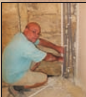
Installazzjoni tad-dawl mis-Sur Peter Psaila
